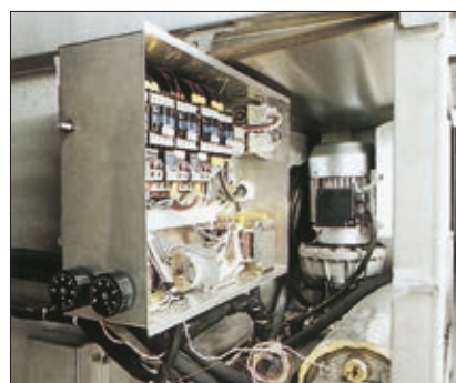
Cuadro eléctrico LP-67
