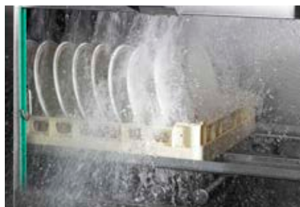
Zona de lavado
